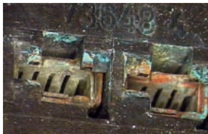
Spojka se stopami vlhkosti a koroze
