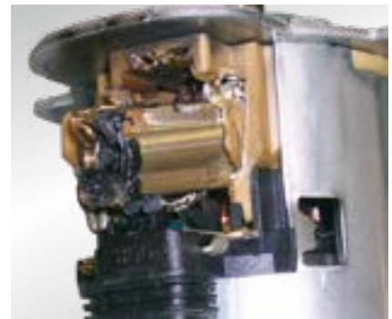
损坏图：电机或电气触点存在熔痕
