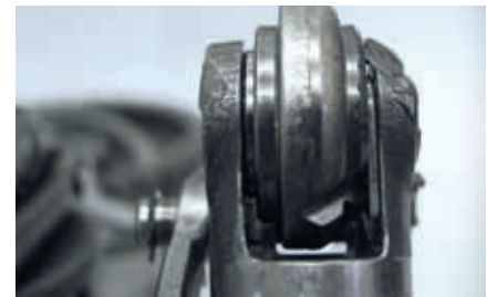
Schadensbild: einseitig abgeschliffene Laufrolle
