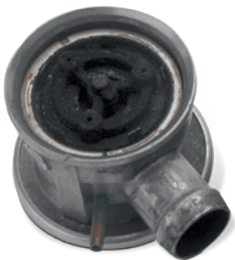
Daños por condensado de gas residual
